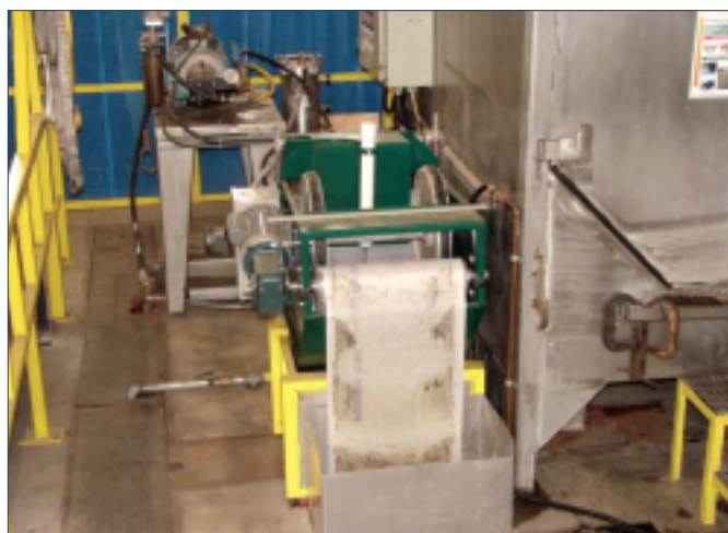
Système de filtration installé chez Filtrindustries chez technologie avancée de Fibres (AFT) à Lennoxville.
